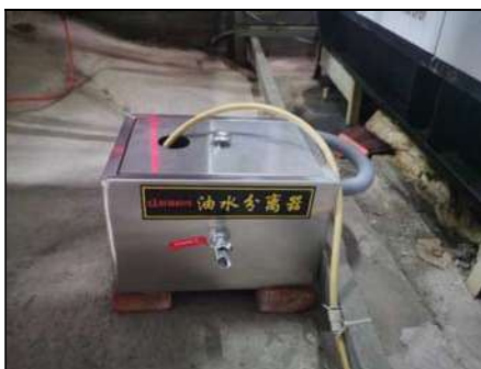
空压机冷凝水油水分离器
