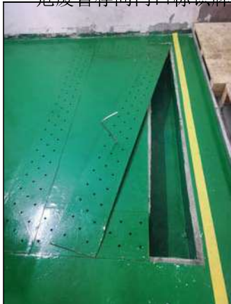
危废间内部截流沟
