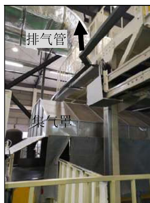
二期热风烧成炉出口
