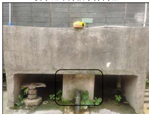
拖把清洗池下方油水分离设施
