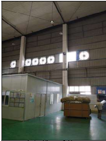
车间排风系统
