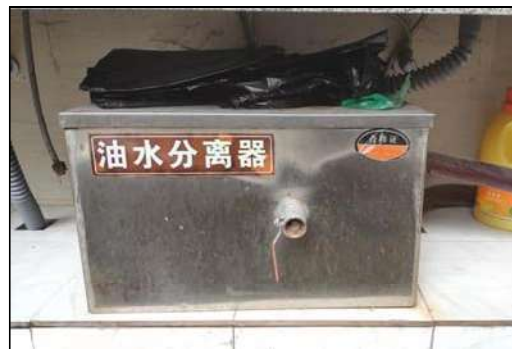
洗手池下方油水分离器
