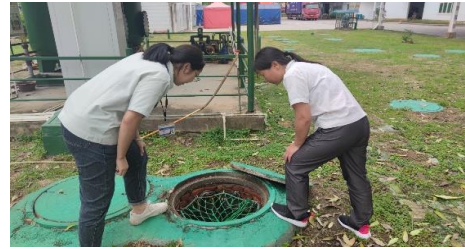
5. 打開集水井井蓋，檢查水泵設備，發現感應器電線連接頭脫落，導致感應器失靈；
